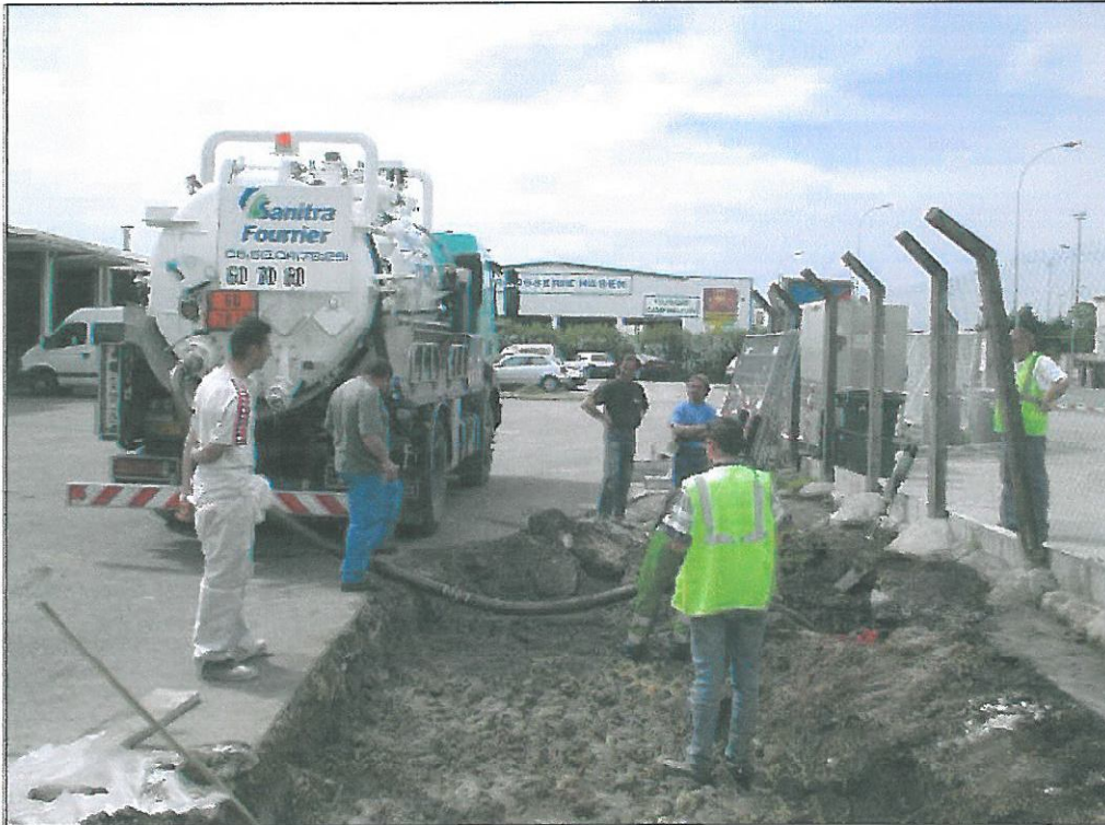
Collecte du mélange hydrocarbures et eau souillée mobilisé par le marnage de la nappe alluviale captive de La Garonne .
