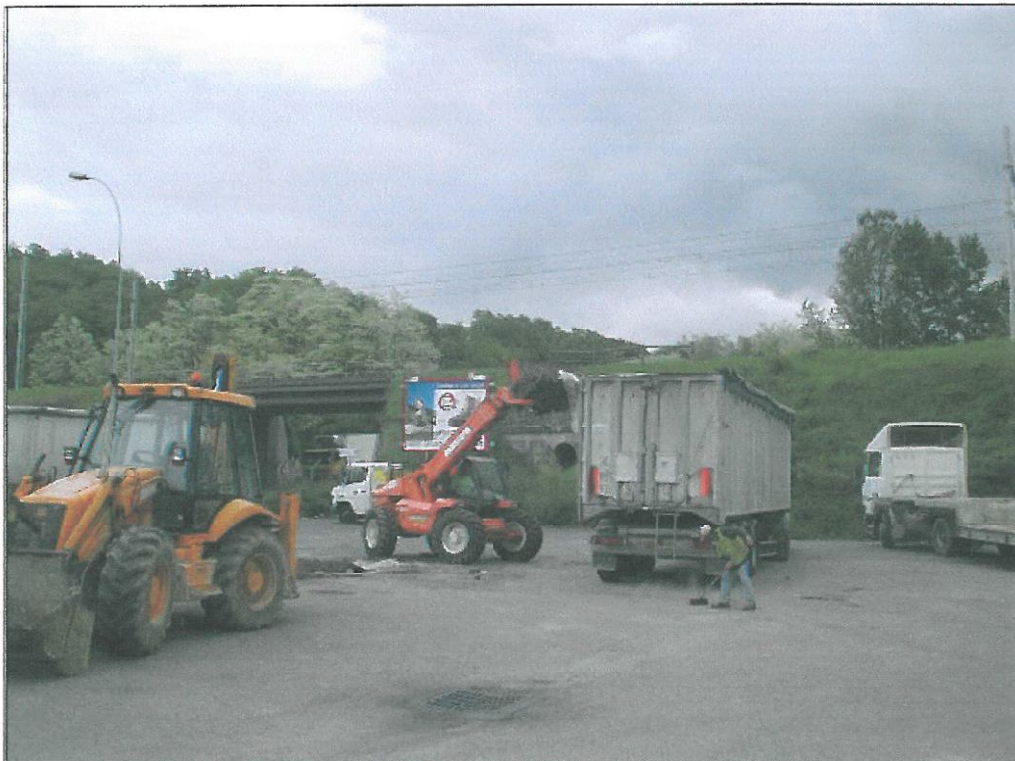
Chargement des terres polluées par hydrocarbures excavées pour évacuation vers centre de traitement agréé.
